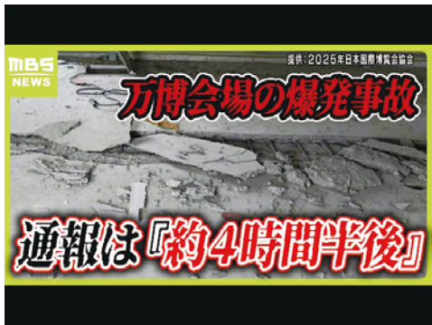
現場作業員は「ビックリするくらいの音だった」と証言。なんで通報が4時間半後？
